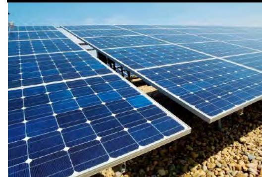
Fotografía 28. "Panel de celda fotovoltaica de la marca SAECSA".
