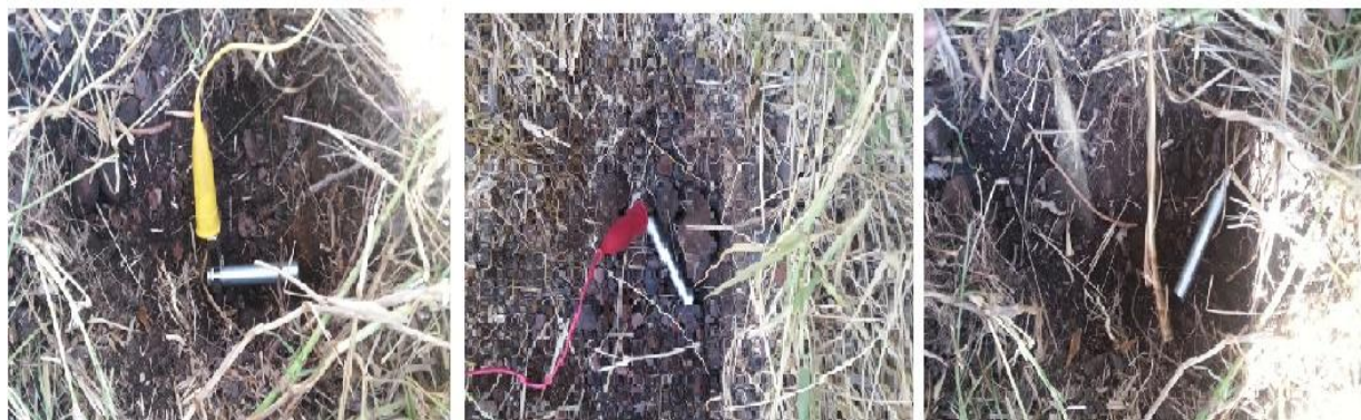
Figura 4.14. Terminales del equipo de medición digital de tierra KYORITSU conectadas a tres electrodos del sistema de puesta a tierra.
