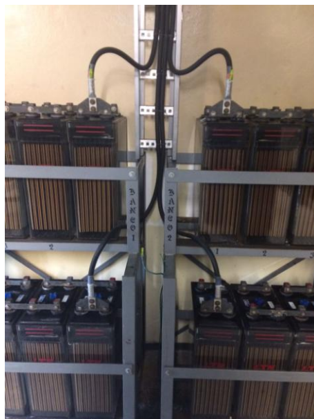
Figura 4.26 Banco de baterías instalado en la central telefónica.
