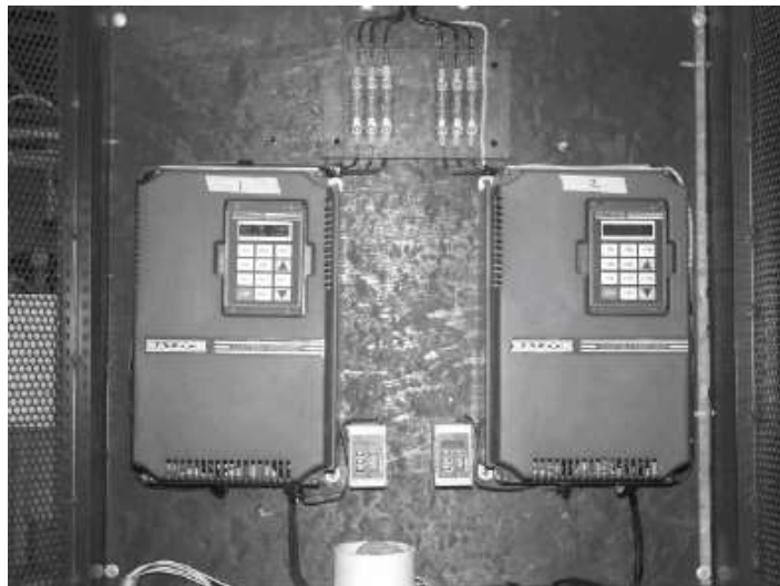
Figura 5.2 Variadores de frecuencia para el control de las bombas
