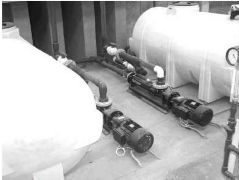
Figura 5.1 Tanques de almacenamiento y bombas de cavidad progresiva.
