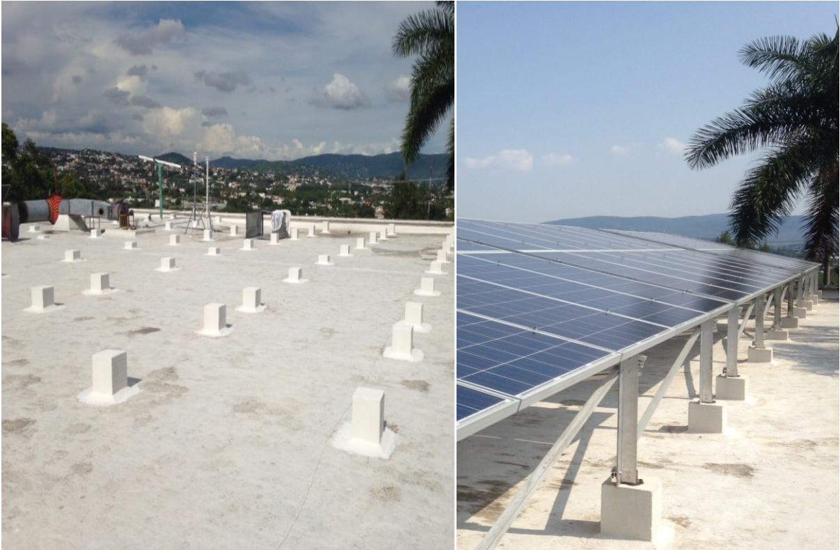
Distribución de las mojoneras sobre la azotea del auditorio Tonatiuh y montaje de las UBM
