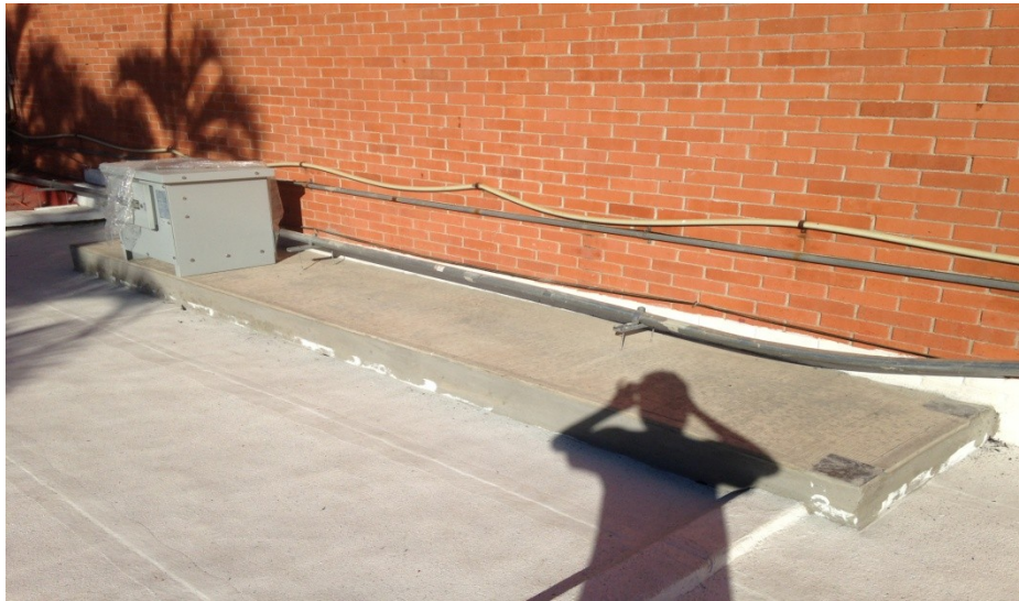
Base para alojar al transformador
