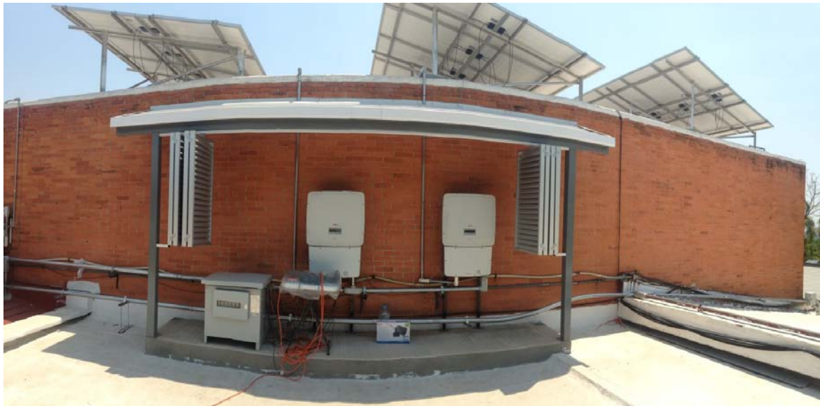
Nicho de los inversores y transformador
