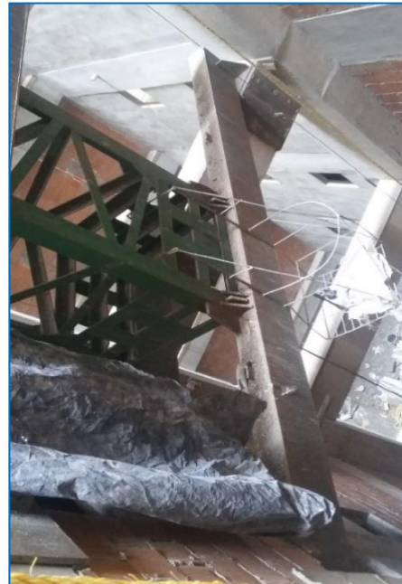
Figura 5.4. Fijación de la torre inferior de la grúa. Fuente: Arq. Michel Tomé Toriz.
