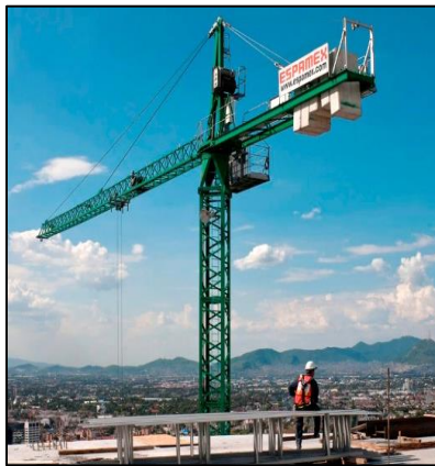
Figura 3.7. Grúa torre marca Jaso. Fuente: www.espamex.com
