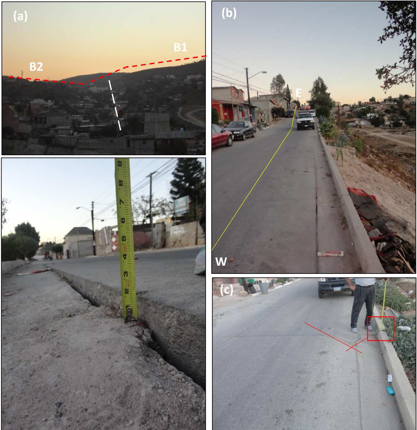
Figura IV. 10 Evidencias de desplazamientos del terreno en el polígono de verificación “B”.
