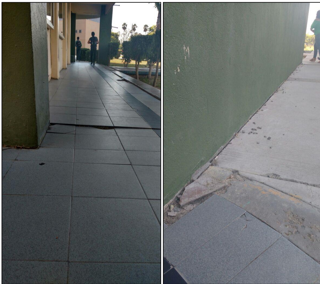
Figura IV. 15 Evidencias de procesos de hundimiento en la Facultad de Humanidades de la UABC. En ambas imágenes, se observan afectaciones en la base de muros, columnas, así como en azulejos de un edificio escolar.
