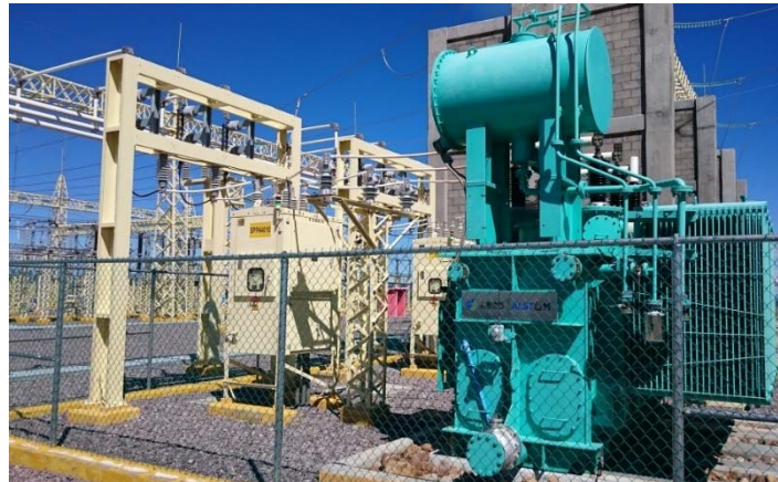
Imagen 4. Equipo de compensación reactiva conectado a bus terciario (detrás se observa interruptor para transformador de servicios propios de la subestación).
