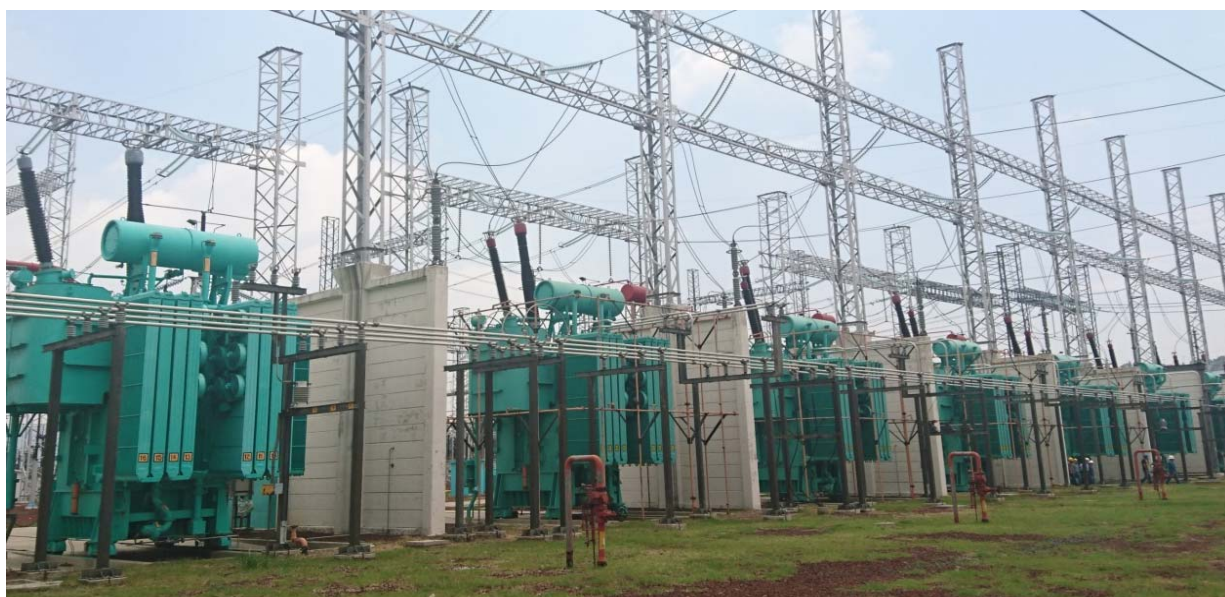
Imagen 3. Bancos de autotransformadores 400/230 kV con bus terciario en media tensión.
