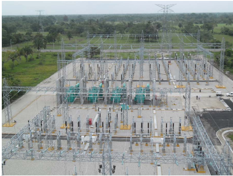
Imagen 1. Subestación Eléctrica 115/230 kV con un banco de autotransformadores.
