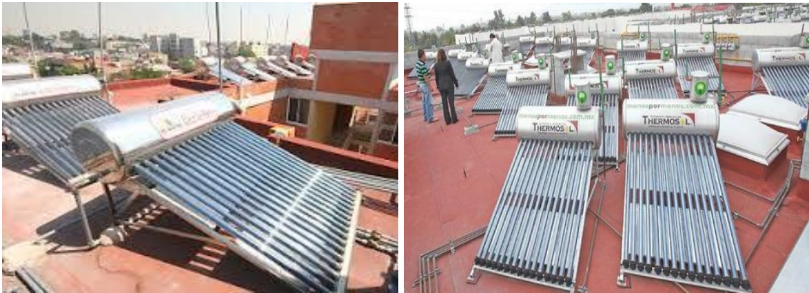
Fotografía 22. Azotea de un edificio INVI mostrando los calentadores solares que deben instalarse por sustentabilidad en cada vivienda antes de ser entregada.
