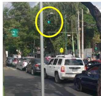
Fotografía 9. Semáforos como sistema de control
