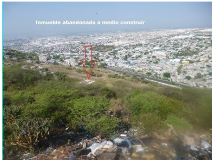
Fotografía 7.- Construcción en obra negra incompleta, se encuentra cerca del paso Ilegal.
