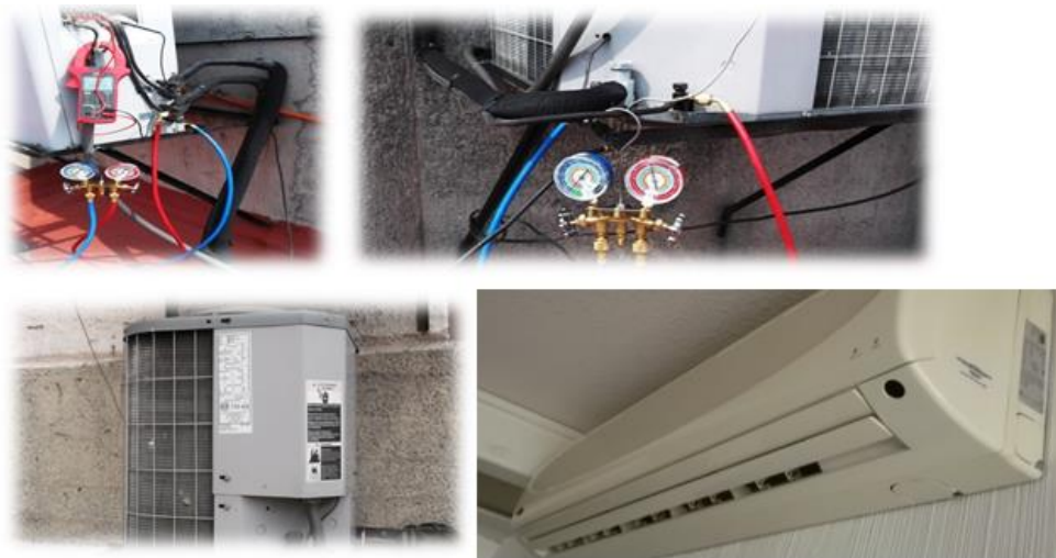
Figura 14. Medición en equipos de refrigeración
