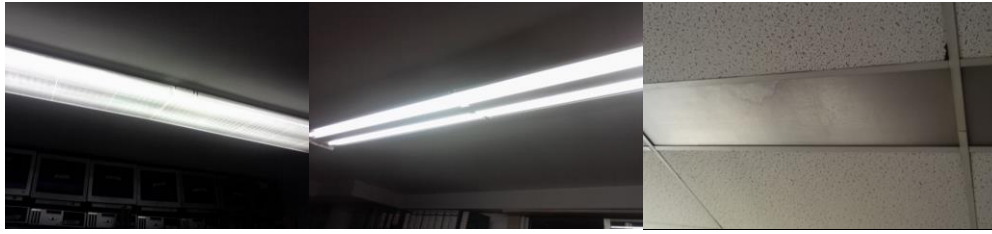
Figura 9. Equipos de iluminación existentes en el inmueble
