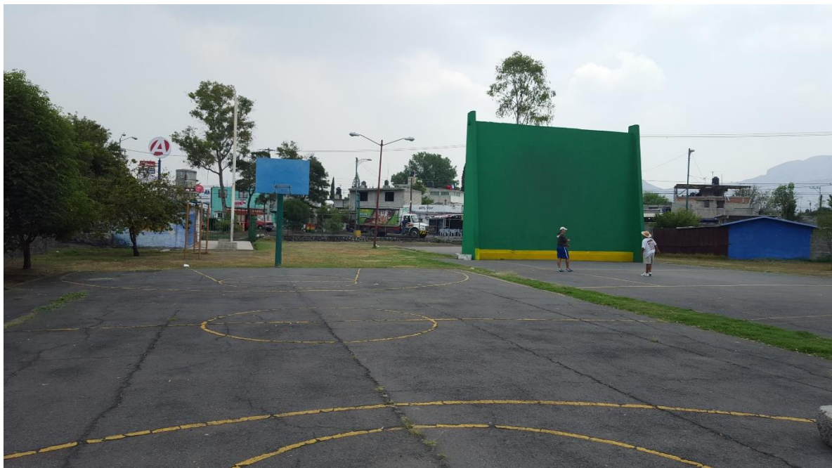
Imagen 9. Deportivo el triángulo. Cancha de basquetbol que presenta fisuras en el pavimento y un balizamiento deteriorado, a la derecha un frontón que no se encuentra en un área delimitada y no cuenta con las medidas oficiales de la CONADE, además que estos espacios se encuentran en el acceso y crean una sectorización en el conjunto. Autoría propia [2016].
