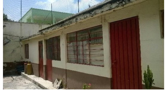
Imagen 13. Se encuentran espacios anexos al edificio original, con el fin de ofrecer más talleres a la población, sin embargo, tienen un déficit en Unidades (UBS) y en mantenimiento. Autoría propia [2016].
