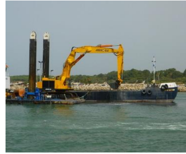
Ilustración 4-6, Descarga del gánguil con pala o dipper con retroexcavadora © Autoridad Portuaria de la Bahía de Cádiz, 2008
