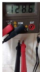
Imagen 126. Medición de voltaje.
