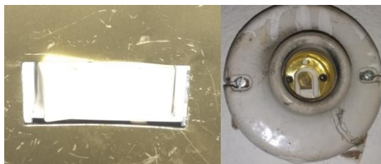
Imagen 130. Apagador apagado y foco retirado.
