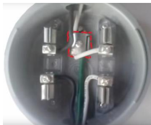
Imagen 100. Puente de unión principal en el medidor
