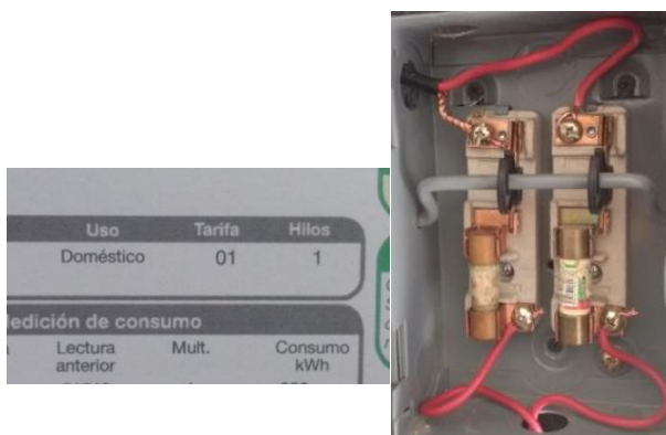
Imagen 135. Revisión de recibo y caja de fusibles.
