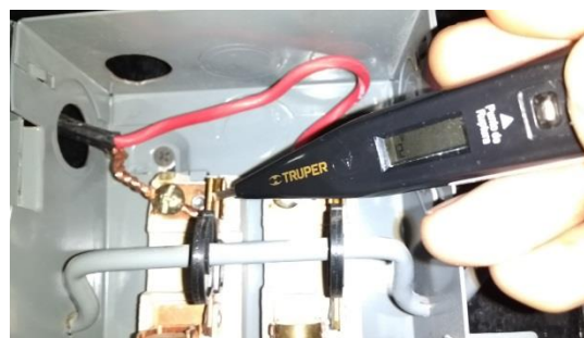
Imagen 137. Neutro en la caja de fusibles.
