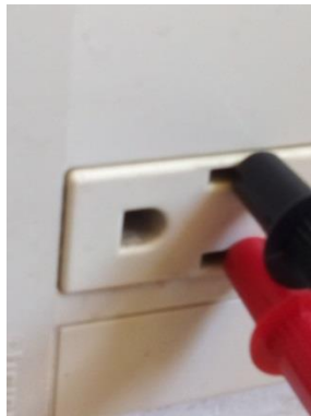
Imagen 123. Prueba de cortocircuito en contacto.
