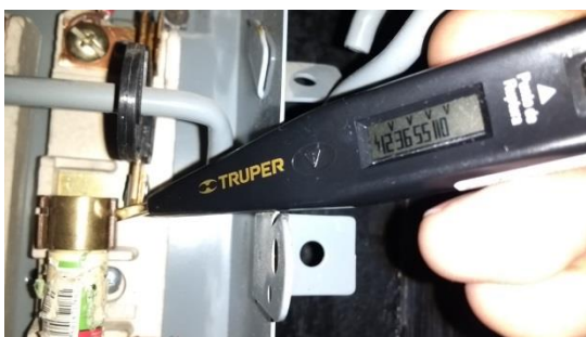
Imagen 136. Fase en la caja de fusibles.
