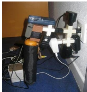
Imagen 55. Sobrecarga originada por demasiadas cargas sobre un circuito.
