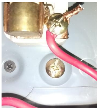
Imagen 138. Tornillo de puesta a tierra.
