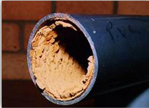
Figura 23. Incrustaciones de carbonato de calcio en tuberías.
