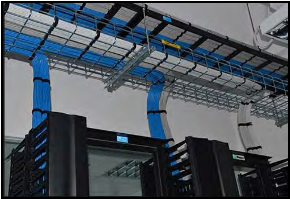
Figura 3 Cableado estructurado en charolas
