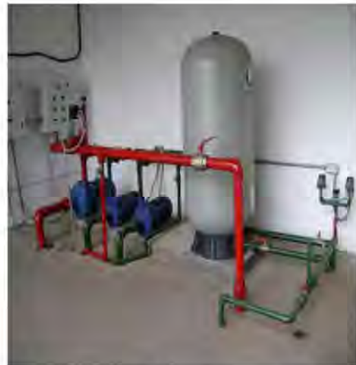
Sistema Hidroneumatico instalado
