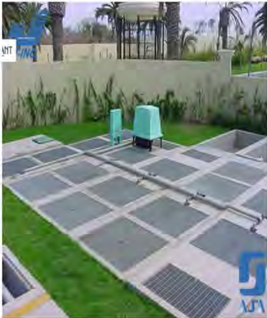
Vista de una planta de tratamiento instalada (ASA)
