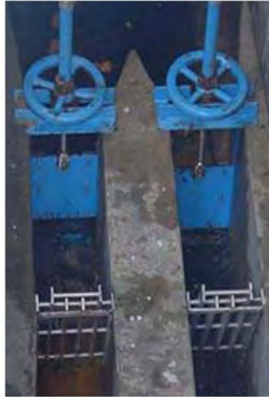
1A- Canal desarenador
