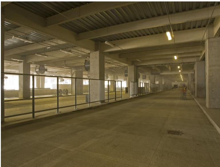
Vista de paraderos en donde se aprecian los materiales, flujos y circulaciones.
