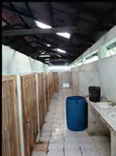
Sanitarios para uso común, ubicados en Ranchería B. Fuente: Mario Espinosa. 2013.
