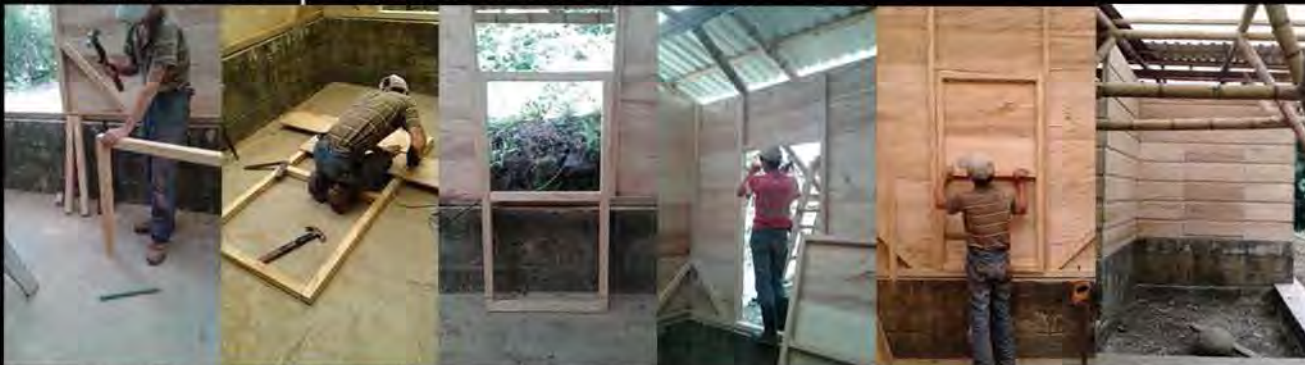
Las fotografías en obra fueron obtenidas por algún miembro del equipo en las diversas etapas de construcción.
