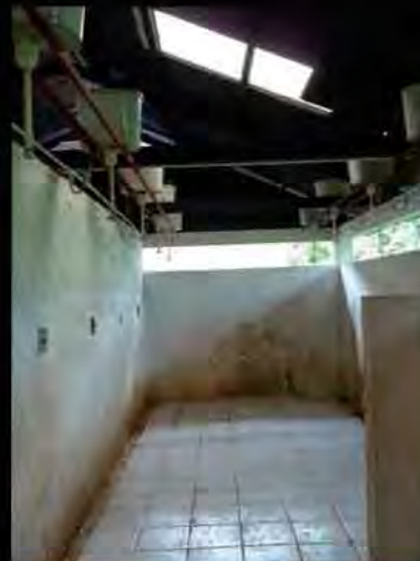
Espacio destinado para regaderas de uso común, ubicados en Ranchería B. Fuente: Mario Espinosa. 2013.
