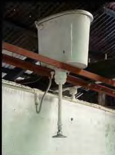
Cajas de agua para regaderas de uso común, ubicados en Ranchería B. Fuente: Mario Espinosa. 2013.
