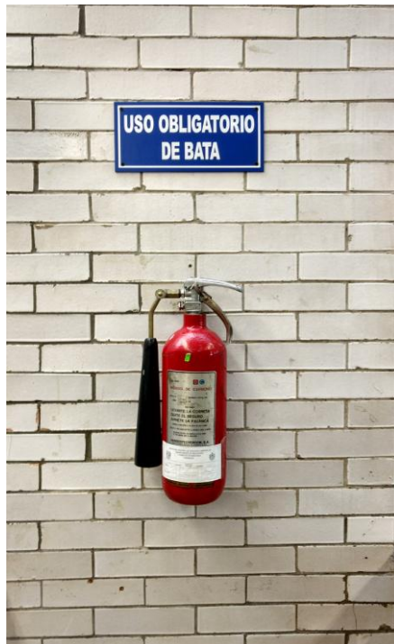
Figura 16. Extintor de emergencia.
