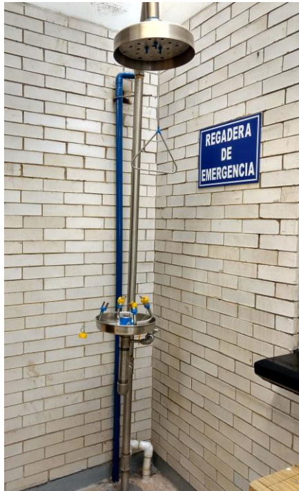
Figura 14. Regadera de emergencia con lavaojos.
