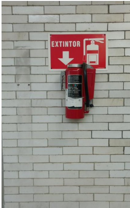
Figura 8. Extintor de emergencia.
