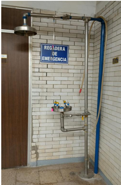
Figura 6. Regadera de emergencia con lavaojos.
