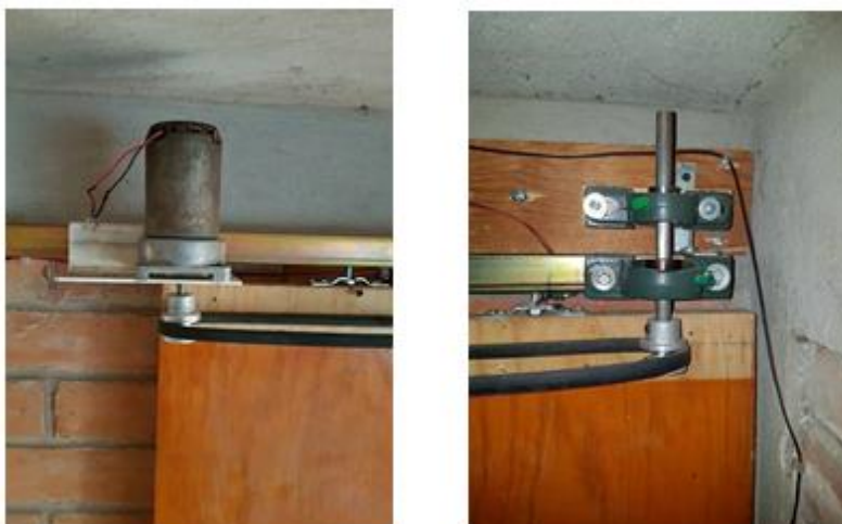
Ilustración 54 motor y chumaceras fijadas al riel
