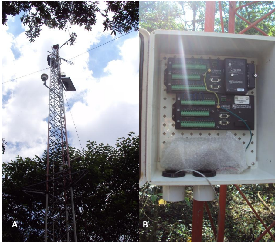
Figura. 3. A) Torre de flujo instalada en el cafetal La Orduña. B) Data logger modelo CR1000
