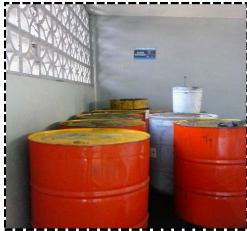
Figura 4.6 Aceite gastado colectado en tambos. Recolectados de manera incorrecta, pues no están encima de una canaleta.
