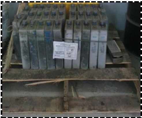
Figura 4.9 Baterías Ni-Cd sobre una tarima de madera con una resistencia insuficiente para soportarlas.
