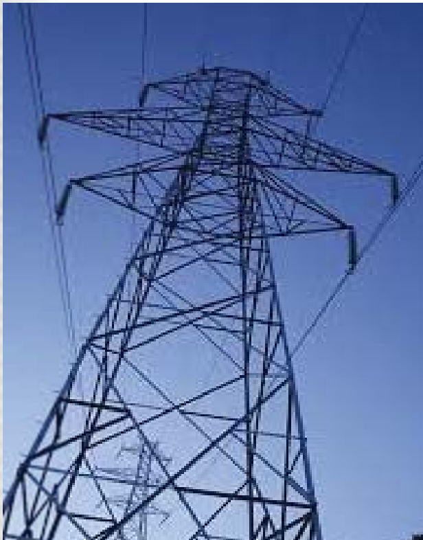
Vista de torre eléctrica delegacional.
