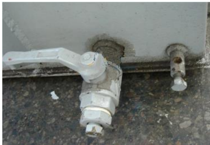
13 Figura 2.1.7 válvula de drenaje
