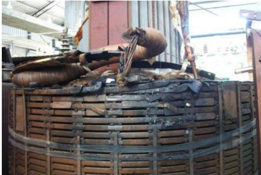
26 Figura 5.5 Cortocircuito en Bobinado de un Transformador.
