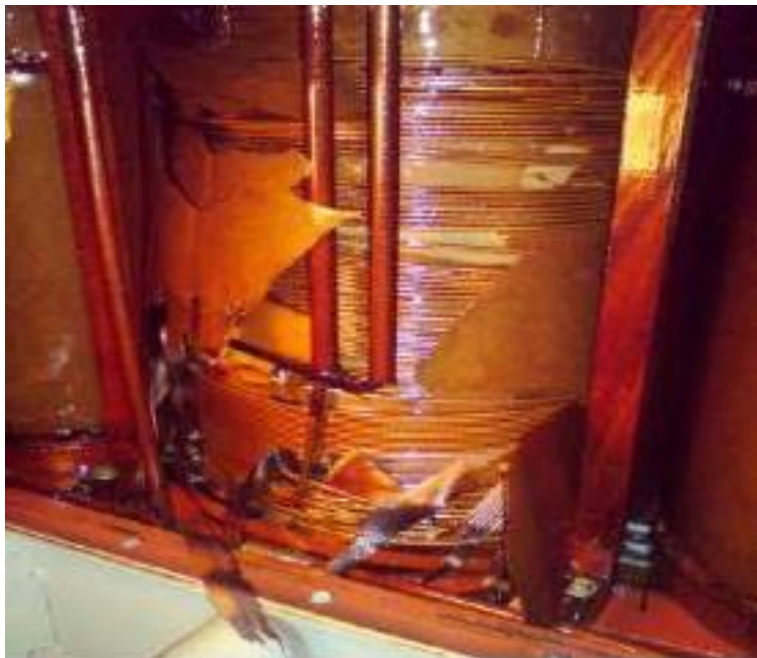
24 Figura3.3 Deterioro del papel aislante de un embobinado
