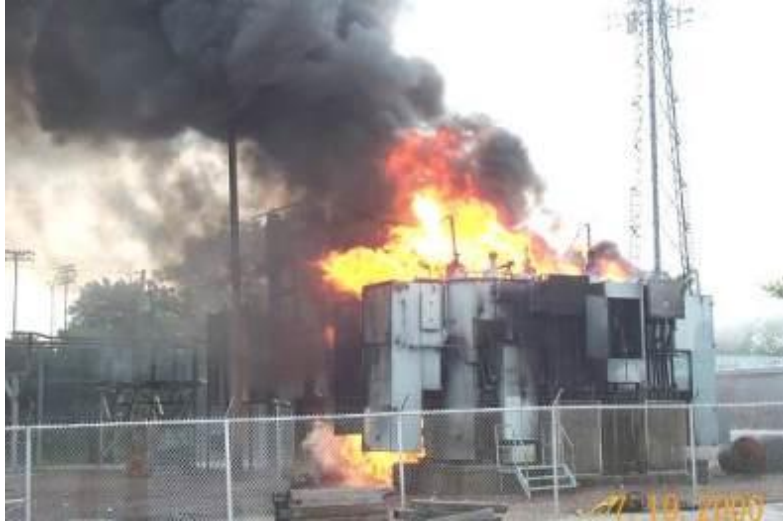
25 Figura 3.4 Efectos de la sobretensión en el transformador
