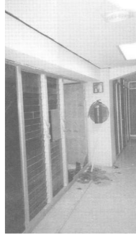
Figura 2.26 Rotura de vidrios en el interior del edificio de hospitalización
