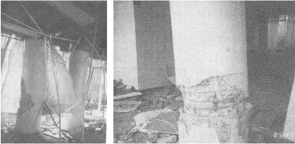
Figura 2.12 Daños en las columnas de la planta baja del edificio 246 por flexo-compresión (Masaki et al., 1996)
