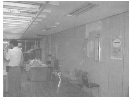
Figura 2.30 Caída de acabados en muros del edificio de Consulta externa
