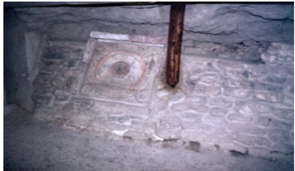
Vestigio de pilote de madera como soporte para desplante del Sagrario Metropolitano
