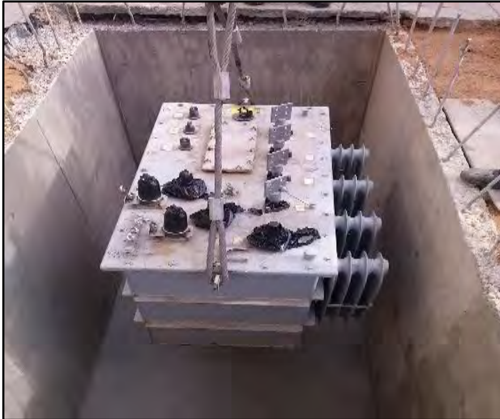
Figura 2.6 Transformador tipo pozo
