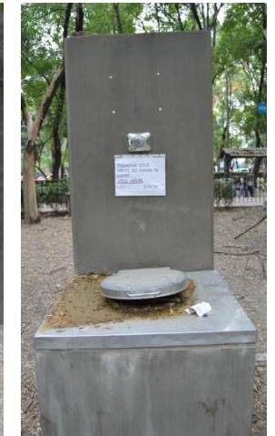
Imagen 3.37 Estado actual del sanitario canino
