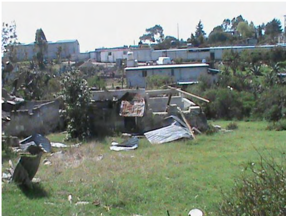
Imagen 15. Daño en una casa del Rancho La Peñuela Fuente: Cortesía de Protección Civil de Acatlán
