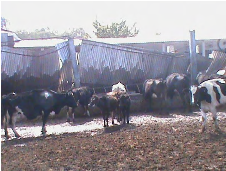
Imagen 8. Láminas fuera de su lugar en el establo Fuente: Cortesía de Protección Civil de Acatlán
