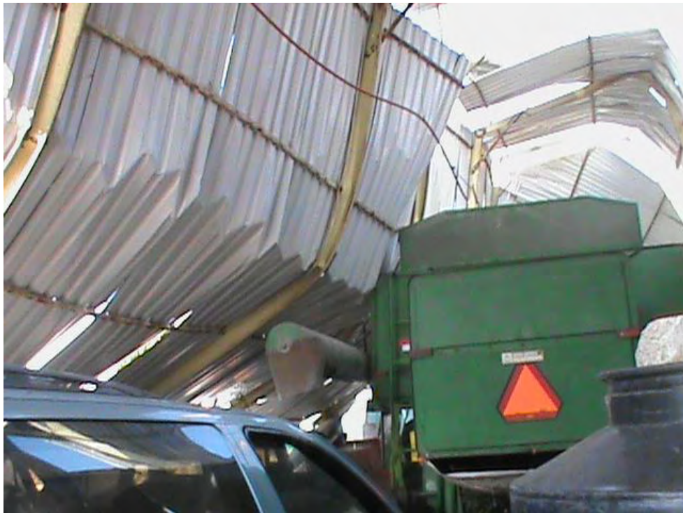
Imagen 3. Daños a una trilladora Fuente: Cortesía de Protección Civil de Acatlán
