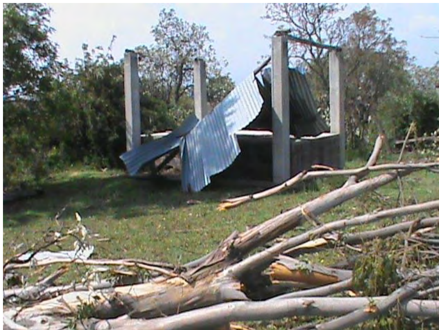
Imagen 19. Láminas caídas y ramas quebradas Fuente: Cortesía de Protección Civil de Acatlán
