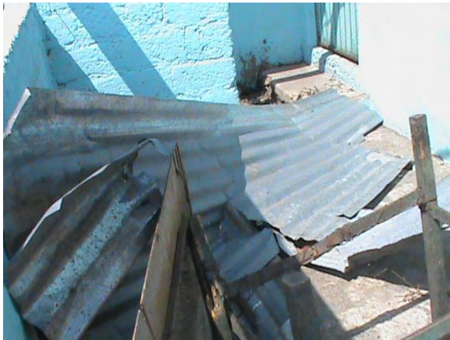
Imagen 21. Láminas partidas y dobladas Fuente: Cortesía de Protección Civil de Acatlán
