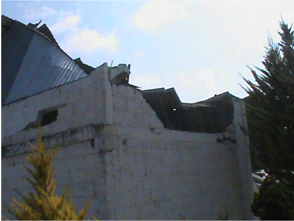
Imagen 5. Techo derrumbado de una casa Fuente: Cortesía de Protección Civil de Acatlán
