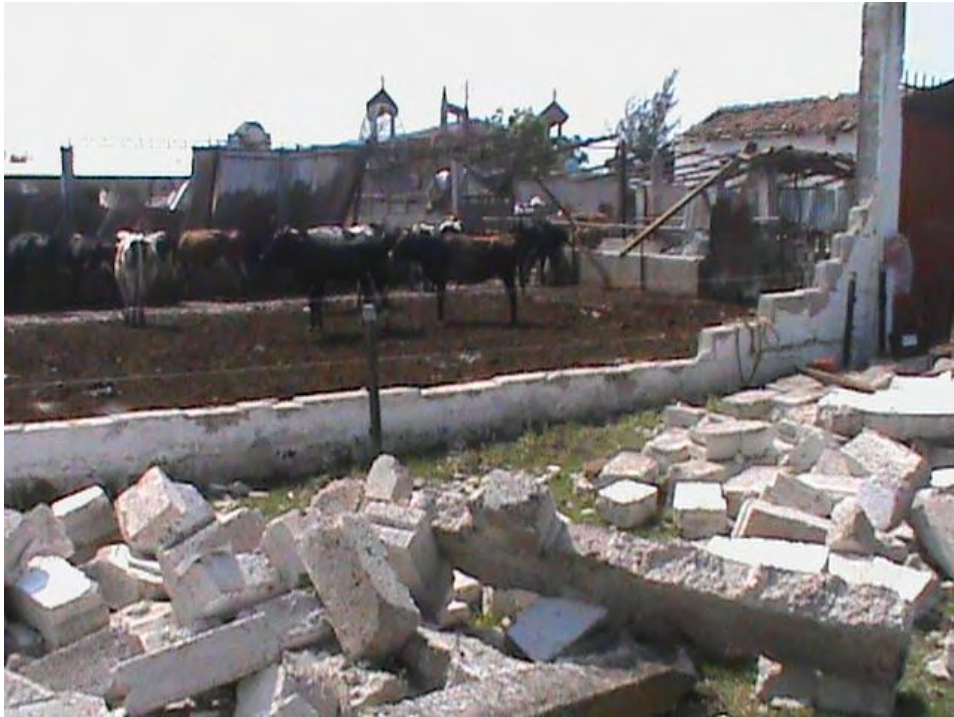
Imagen 6. Bloques de cemento dañados en la parte del establo Fuente: Cortesía de Protección Civil de Acatlán
