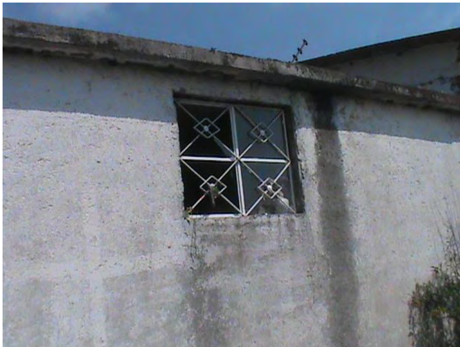
Imagen 17. Daños en las ventanas Fuente: Cortesía de Protección Civil de Acatlán
