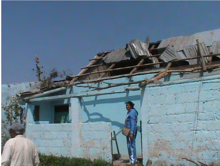
Imagen 20. Techo de una casa totalmente dañado Fuente: Cortesía de Protección Civil de Acatlán
