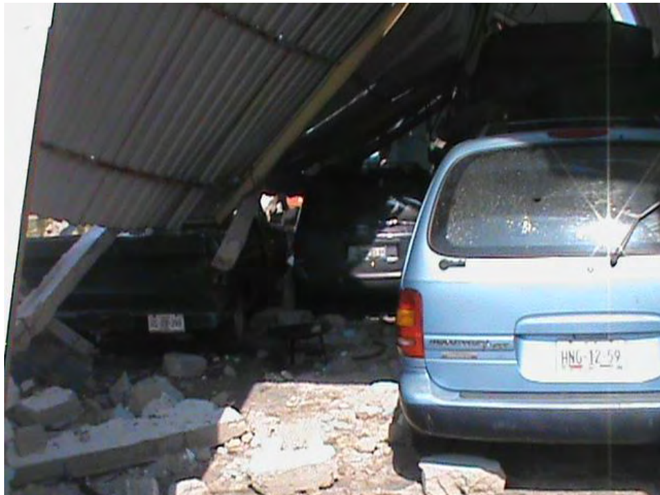
Imagen 2. Daños en láminas y camionetas en la bodega del Rancho La Peñuela Fuente: Cortesía de Protección Civil de Acatlán
