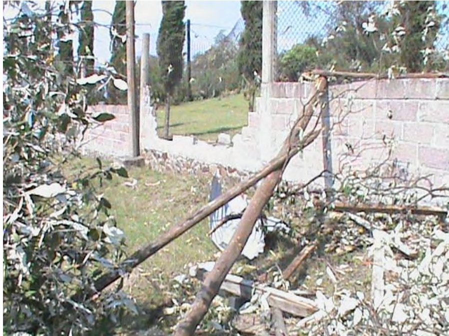
Imagen 14. Pared derrumbada y ramas quebradas Fuente: Cortesía de Protección Civil de Acatlán
