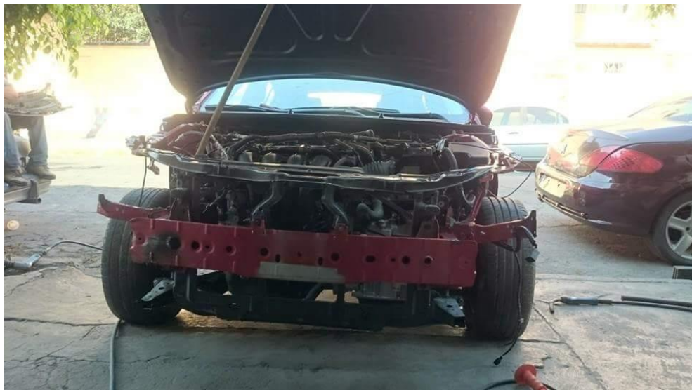
Fig. 16 Armado de puntas con alma y marco radiador.
