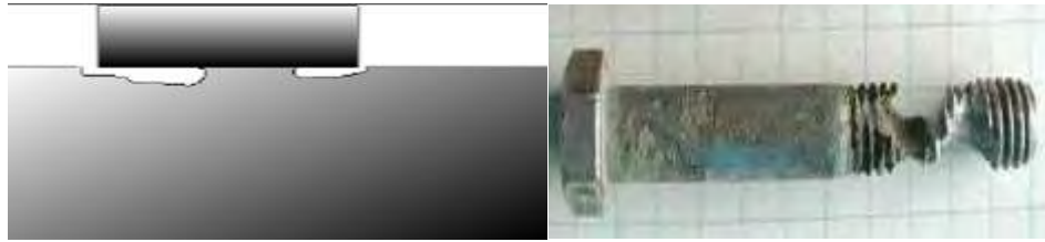
Figura 25. Corrosión en hendiduras o grietas.
