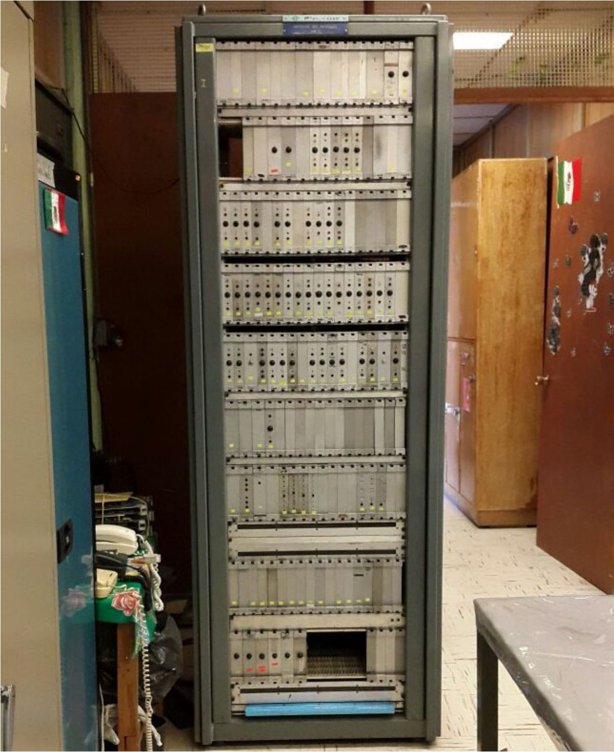
Figura 4.4. Armario de PA de la estación Gómez Farías
