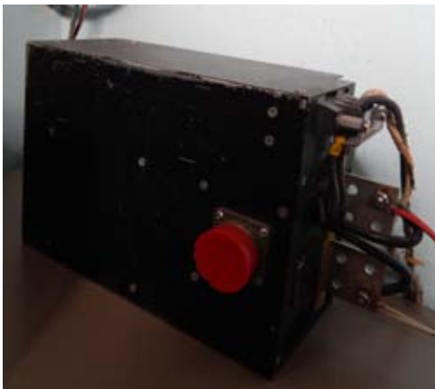
Figura 3.6. Fuente de alimentación del armario de PA
