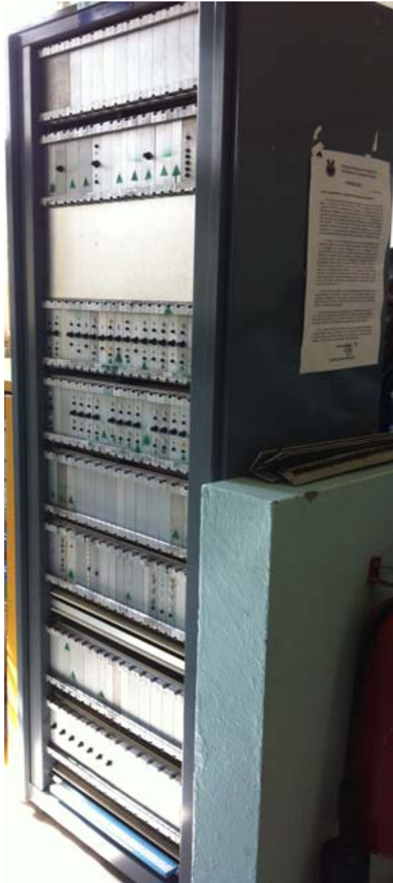
Figura 3.5. Armario de la estación Gómez Farías
