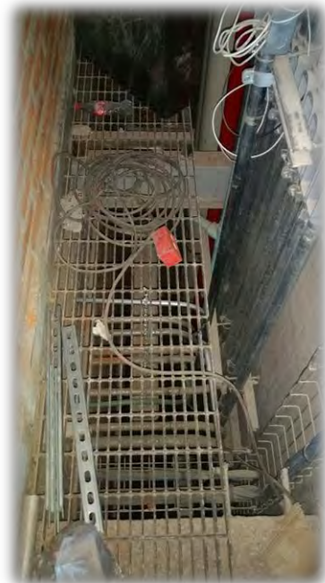
Cuarto de instalaciones
