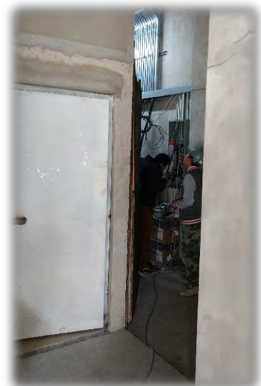
Cuarto de instalación eléctrica
