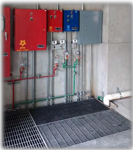
Instalaciones eléctricas y especiales
