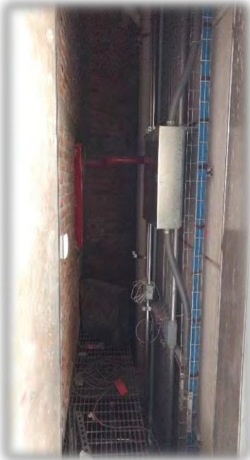
Cuarto de instalaciones
