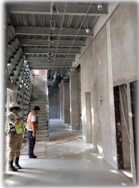
Pasillo de primer piso (elevadores, baños, bodegas, cuarto de instalaciones)
