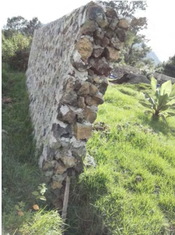
Fotografía 3.1 Muro divisorio sin terminar, encontrado en el sitio.
