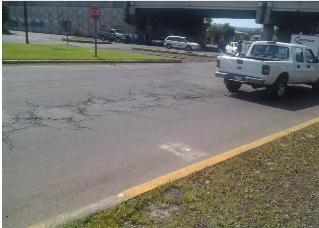
Imagen 3.8.- Tráfico vehicular y estado de la carpeta asfáltica.
