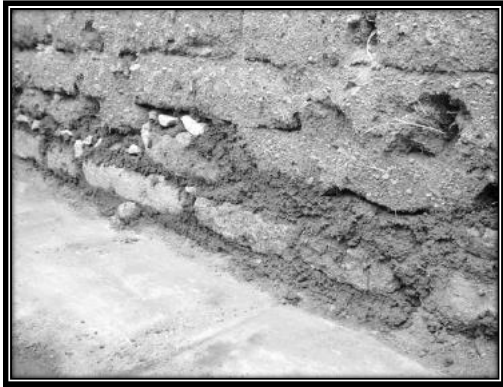
Imagen 2.9.- Muro de adobe con faltantes en juntas.
