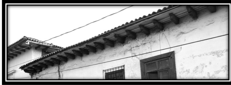
Fotografía 5.5.- Vigas dañadas de la fachada de Manuel Ocaranza (Anexo 2).
