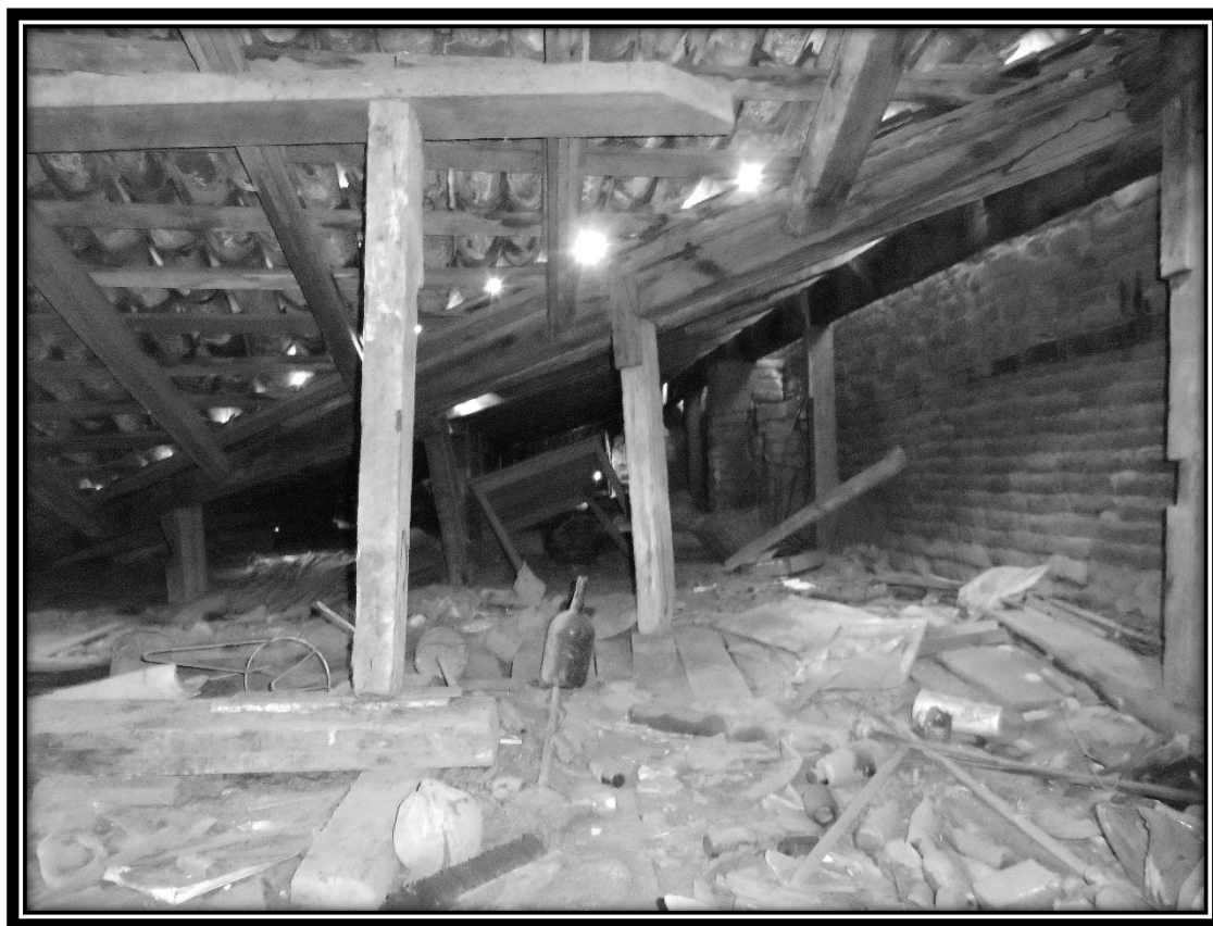
Fotografía 5.10.- Tapanco, elemento aún servible del inmueble.
