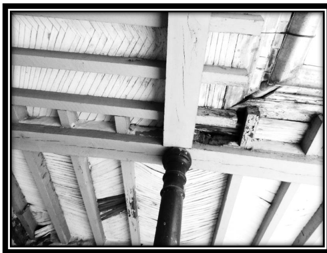
Fotografa 5.4.- Interseccin de traves sobre una columna, franja de agrietamiento longitudinal. Ubicado en el patio central, ver plano (anexo 1).
