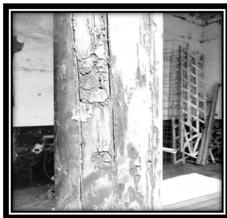
Fotografía 5.8.- Columna circular dañada, apolillada y con humedad.
