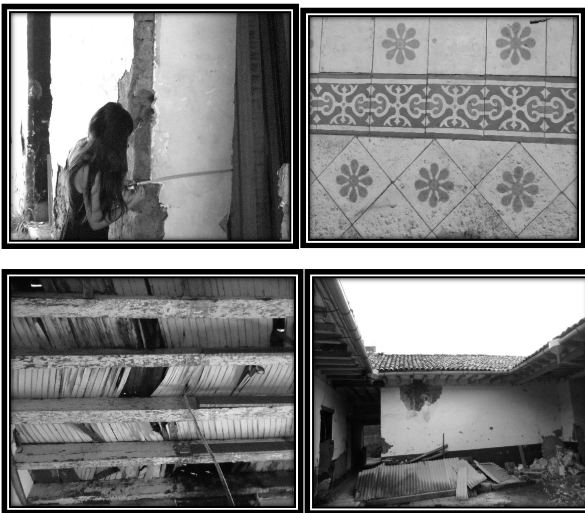
Fotografía 3.5.- Elementos estructurales dañados con materiales originales (adobe, mosaico, teja, madera).
