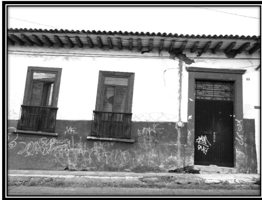
Fotografía 5.1.- Deterioro de fachada de la calle Libertad.
