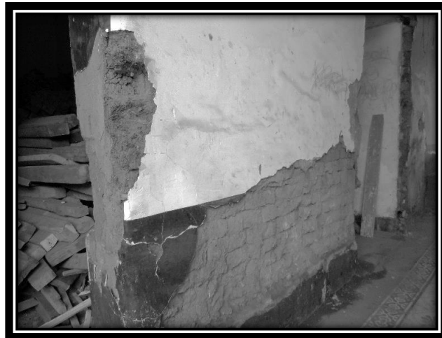
Fotografía 5.3.- Muro interno del inmueble muy dañado, ubicado en el eje (G,8) (Anexo1).
