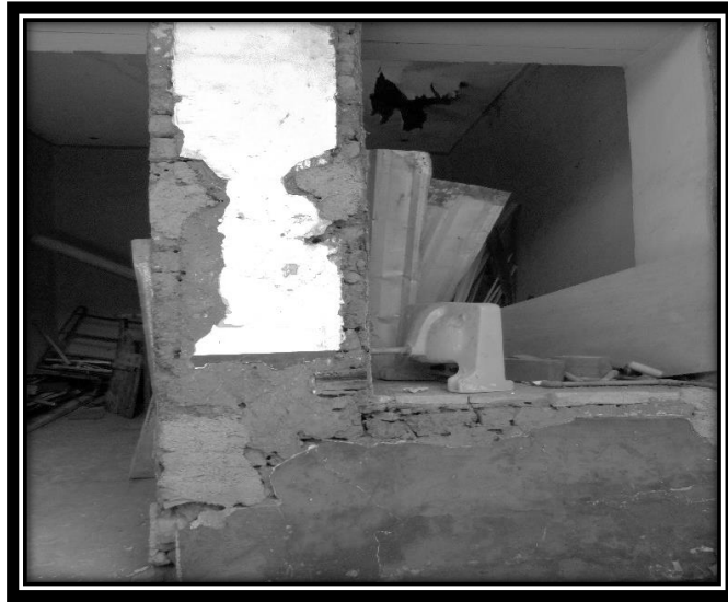
Fotografía 5.2.- Muro interno del inmueble con pérdida del aplanado mayor del 40%, ubicado en el eje (G, 5) del plano (Anexo 1).
