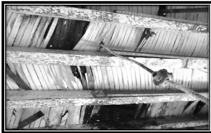
Fotografía 5.9.- Tejamanil en pésimas condiciones.
