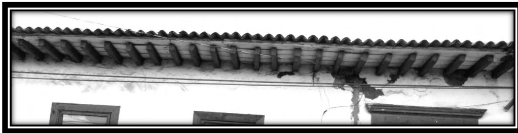
Fotografía 5.6.- Vigas dañadas de la fachada de Manuel Ocaranza (Anexo 2).
