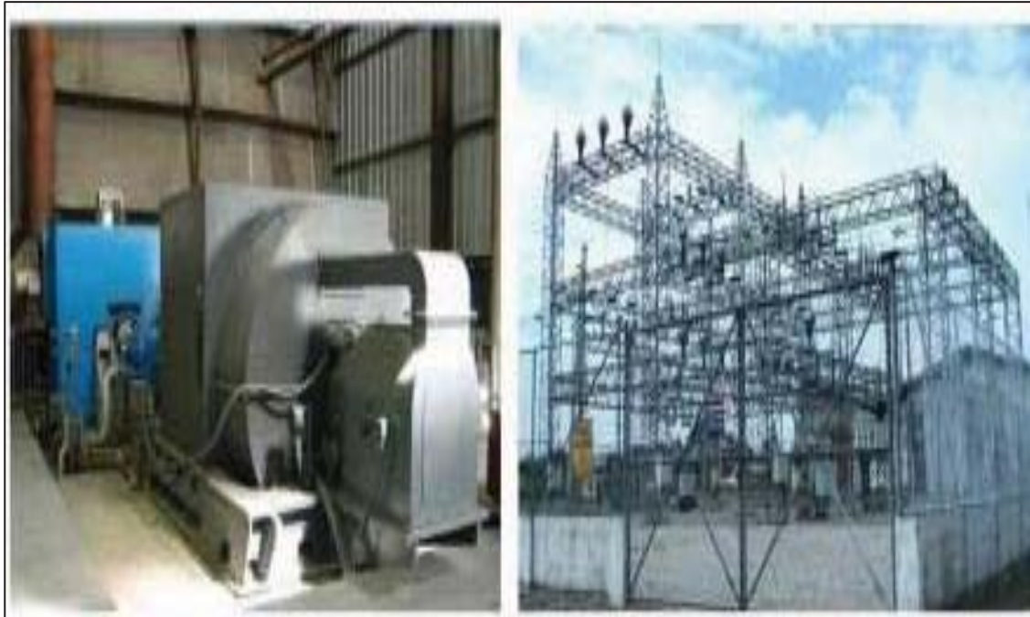
Ilustración 12. Turbina y subestación eléctrica
