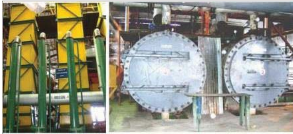
Ilustración 4 Torres de Sulfatación y Clarificadores
