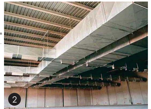
▲ Para la instalación se propone utilizar ductos de lámina de acero galvanizado, calibre 20.
