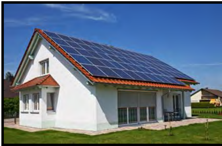
Figura 2.10 Sistema FV instalado en una vivienda 18
