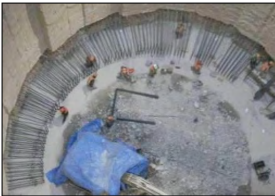
FOTOGRAFIA 26. Construcción de la trabe de liga; unión estructural del Muro Milán con método Convencional.
