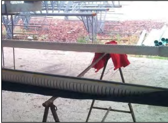
FOTOGRAFIA 12. Tubería ranurada utilizada para la instalación de un tubo de observación a 145m de profundidad.
