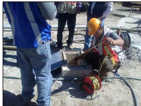
FOTOGRAFIA 08. Monitoreo de piezómetro abierto.
