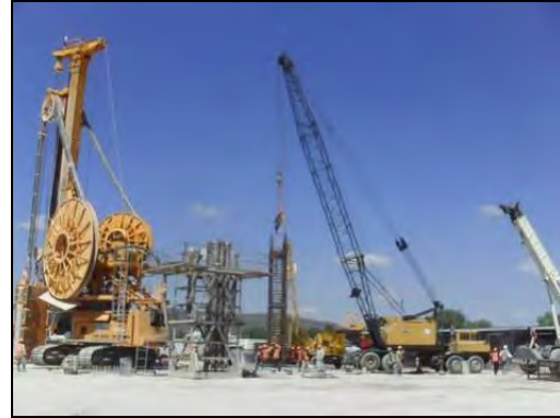
FOTOGRAFIA 19. Durante la construcción del Muro Milán se realizaron trabajos simultáneos: perforación con equipo guiado y colocación de acero de refuerzo de los paneles y colocación de concreto con tubería tremie.
