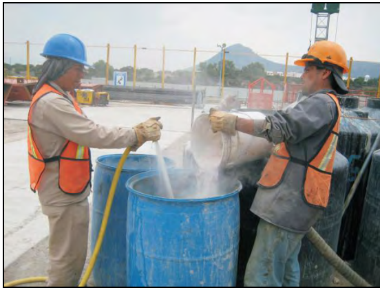
FOTOGRAFIA 10. Trabajos de preparación de mezcla agua-cemento-bentonita para la inyección en el espacio anular de la tubería guía y el barrenado.
