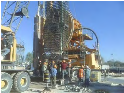
FOTOGRAFIA 20. Colocación de acero de refuerzo para el Muro Milán dentro de la perforación
