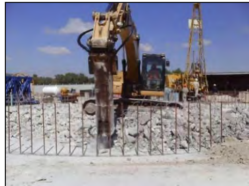
FOTOGRAFIA 21. Demolición de núcleo interior: se da inicio a la excavación de núcleo de la Lumbraera: al fondo de la imagen se observa el equipo de perforación para la instalación de un inclinómetro dentro del Muro Milán.
