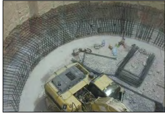
FOTOGRAFIA 25. Escarificado de tableros previo al habilitado y armado de acero de refuerzo para la trabe de liga.
