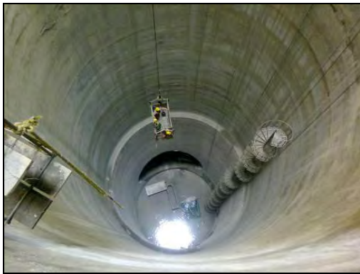
FOTOGRAFIA 35. Panorama general de la Lumbra al término de su construcción; en la figura se aprecia la colocación de instalaciones auxiliares.
