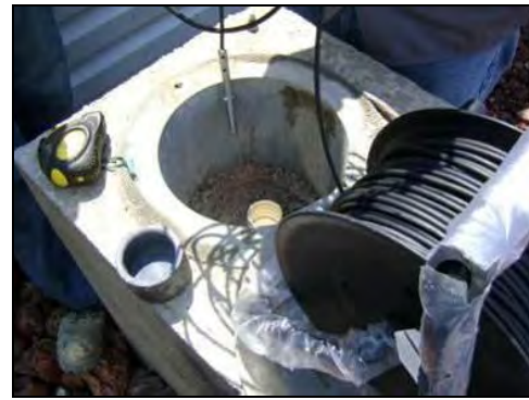
FOTOGRAFIA 15. Monitoreo de tubo de observación con sonda piezométrica (sonda acústica).
