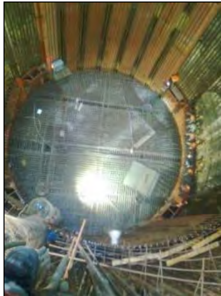
FOTOGRAFIA 32. Panorama de la Lumbreira L-20 al término del armado de acero de refuerzo de losa de fondo, colocación de estructura de emportalamiento en la entrada de túnel, revestimiento con acero de refuerzo en las paredes de la Lumbreira.
