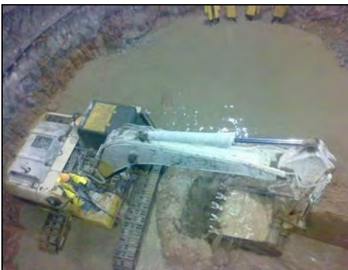
FOTOGRAFIA 28. Conforme se avanza en la construcción de la Lumbraera se presentan importantes filtraciones de agua hacia el interior; en la imagen se observa la construcción del cárcamo para bombeo de achique.
