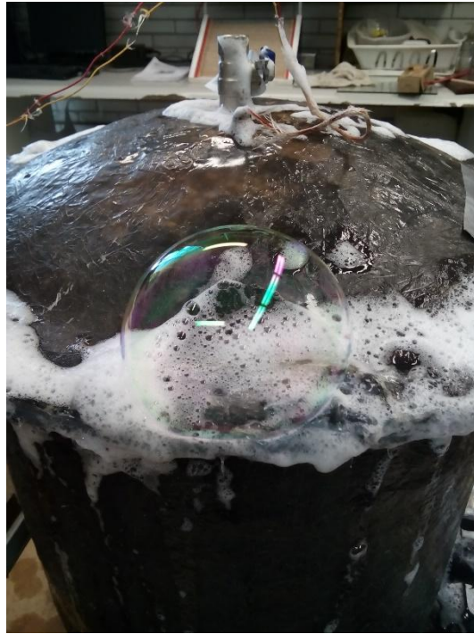
Figura 2.4. Localización de una fuga en el cuerpo del biodigestor.
