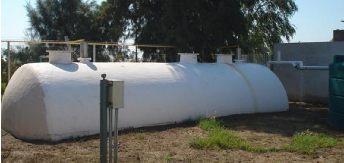
Figura 1.7. Biodigestor horizontal semi – subterráneo (Eduardo Gropelli, 2016).
