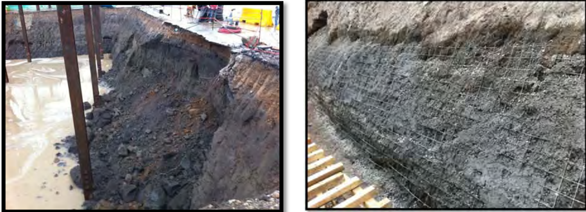
Ilustración 68. Talud caído y talud con concreto lanzado.
