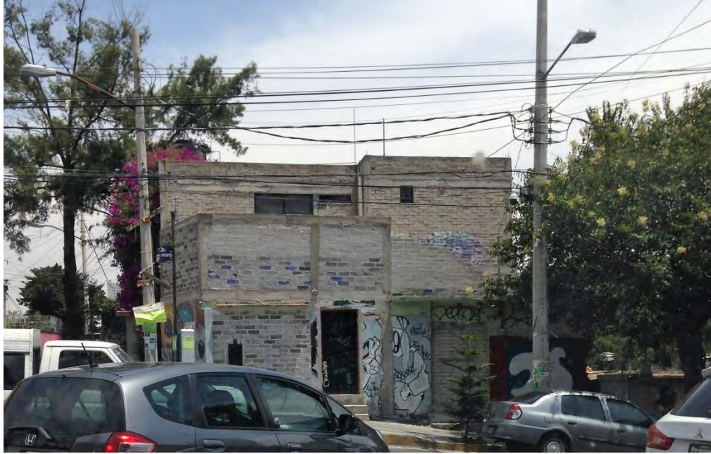
Fig. 50 Construcción inconclusa o sin acabados.
