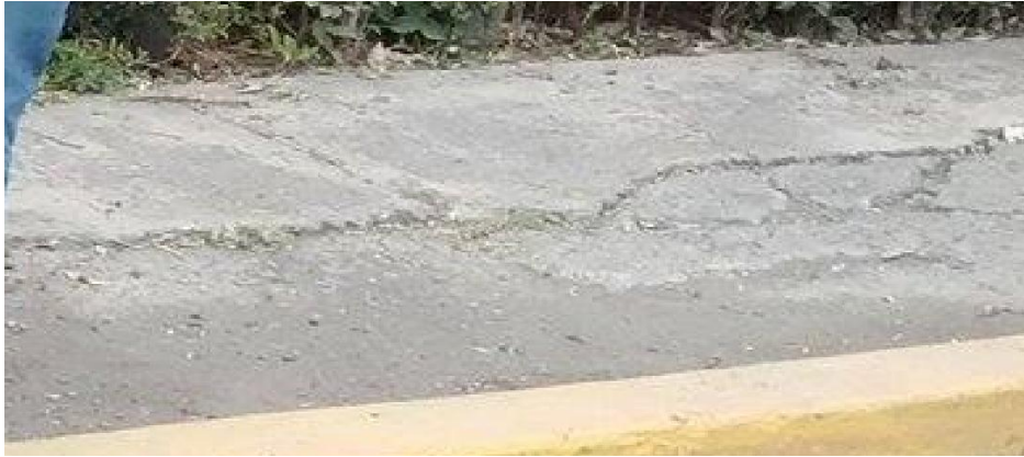
Imagen 2. Banquetas con fallas en el concreto.
