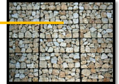
Muro gavión, a base de perfil y piedra de la región.
