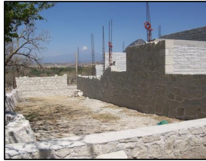
Área de lavado de material
