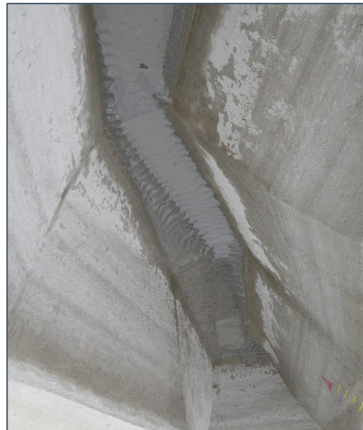
Figura 3.6.3.3. Sedimento fino depositado entre el cadenamiento 136+000 y 139+000
