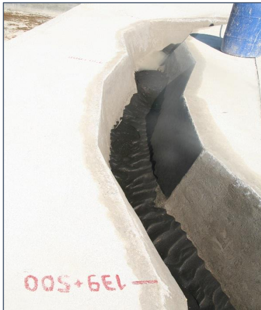
Figura 3.6.2.2. Depósito de sedimento antes del cadenamiento 139+500
