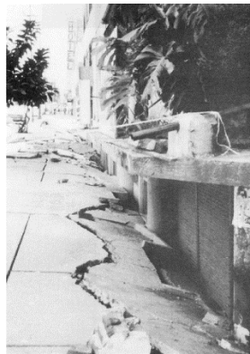
Figura II.8 Ejemplo de un edificio dañado por asentamientos
