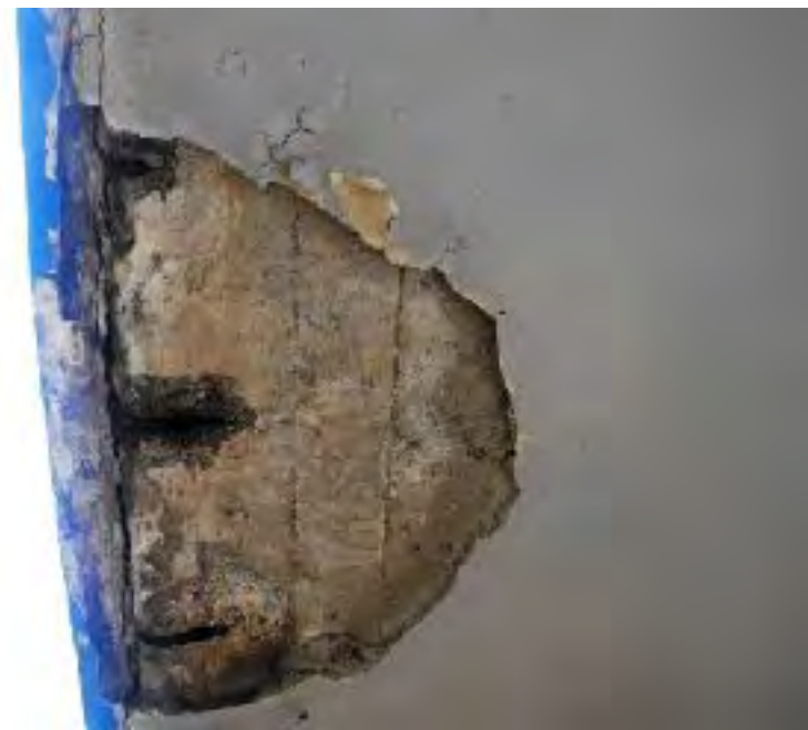
Imagen 49: Deficiente unión entre elementos estructurales y arquitectónicos
