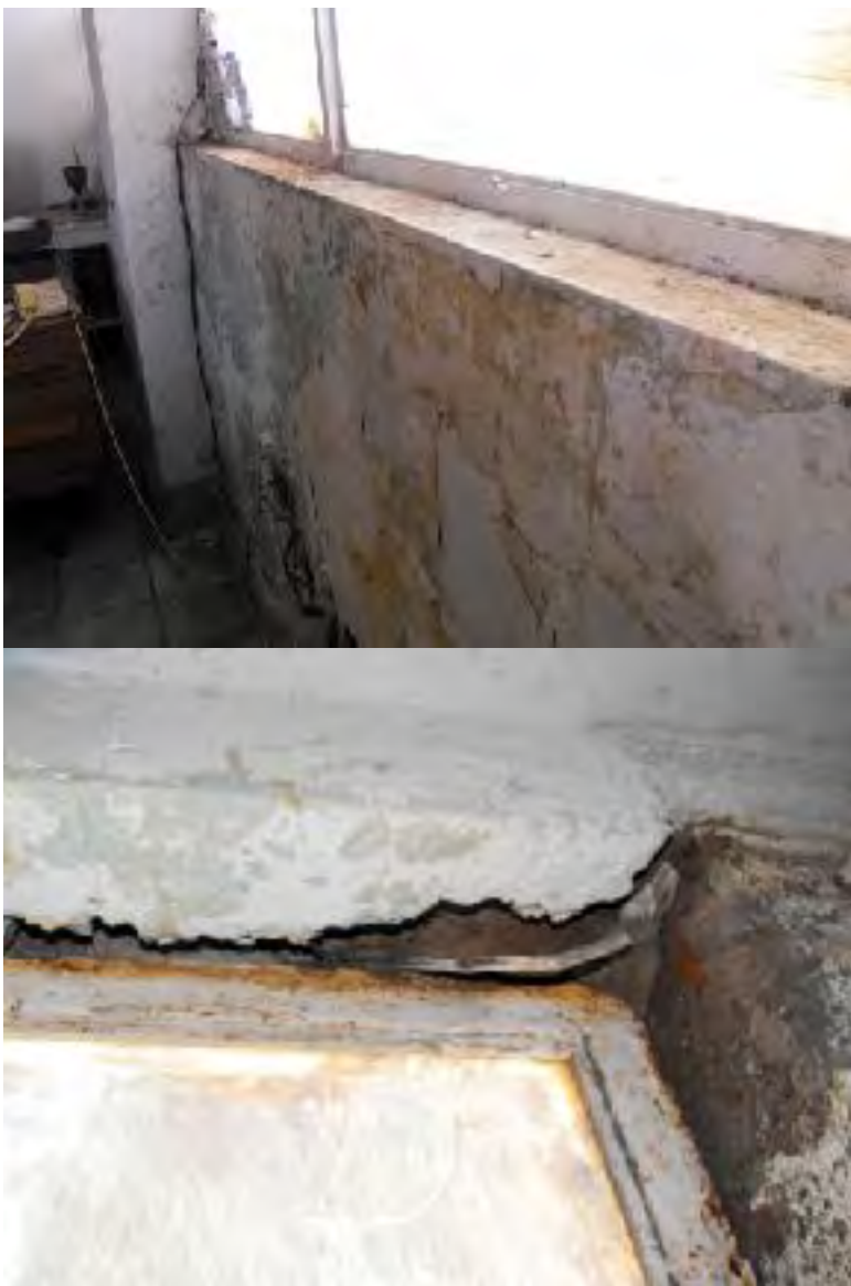
Imagen 50: Deficiente unión entre elementos estructurales y arquitectónicos
