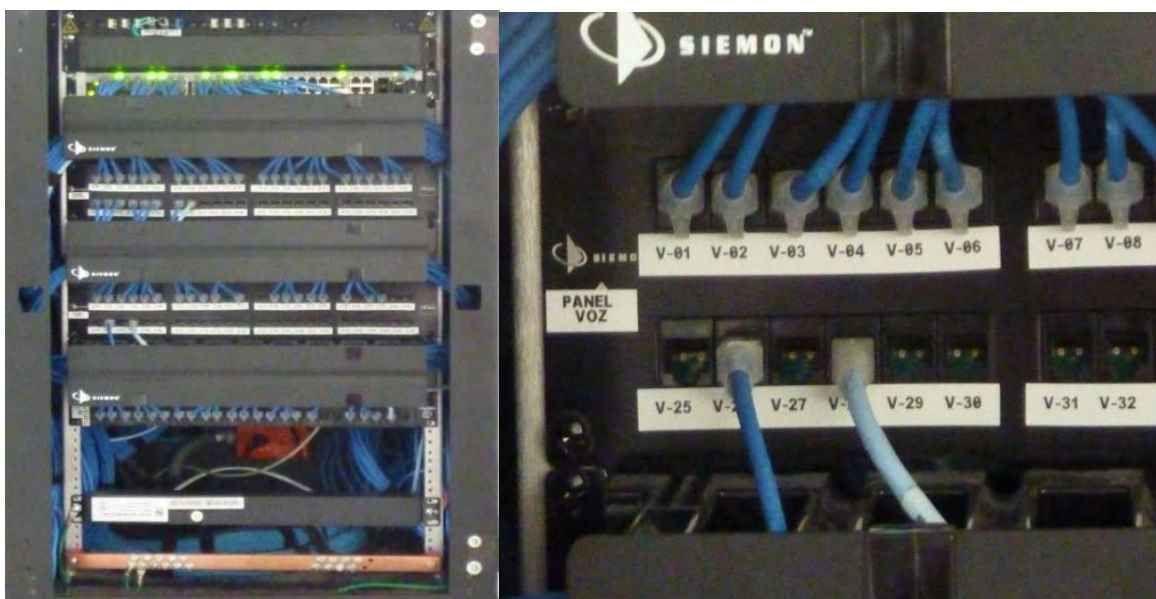
Fotografía 4.2.3f Gabinete terminado e interconectado con servicios identificados
