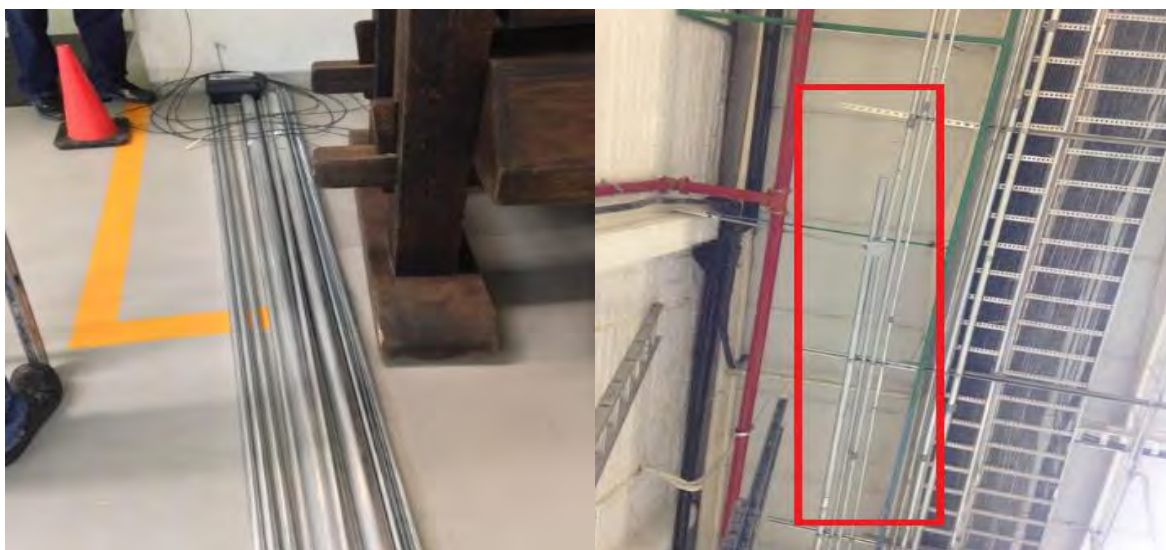
Fotografía 4.2.1a. Tubería galvanizada de diferentes medidas para la canalización
