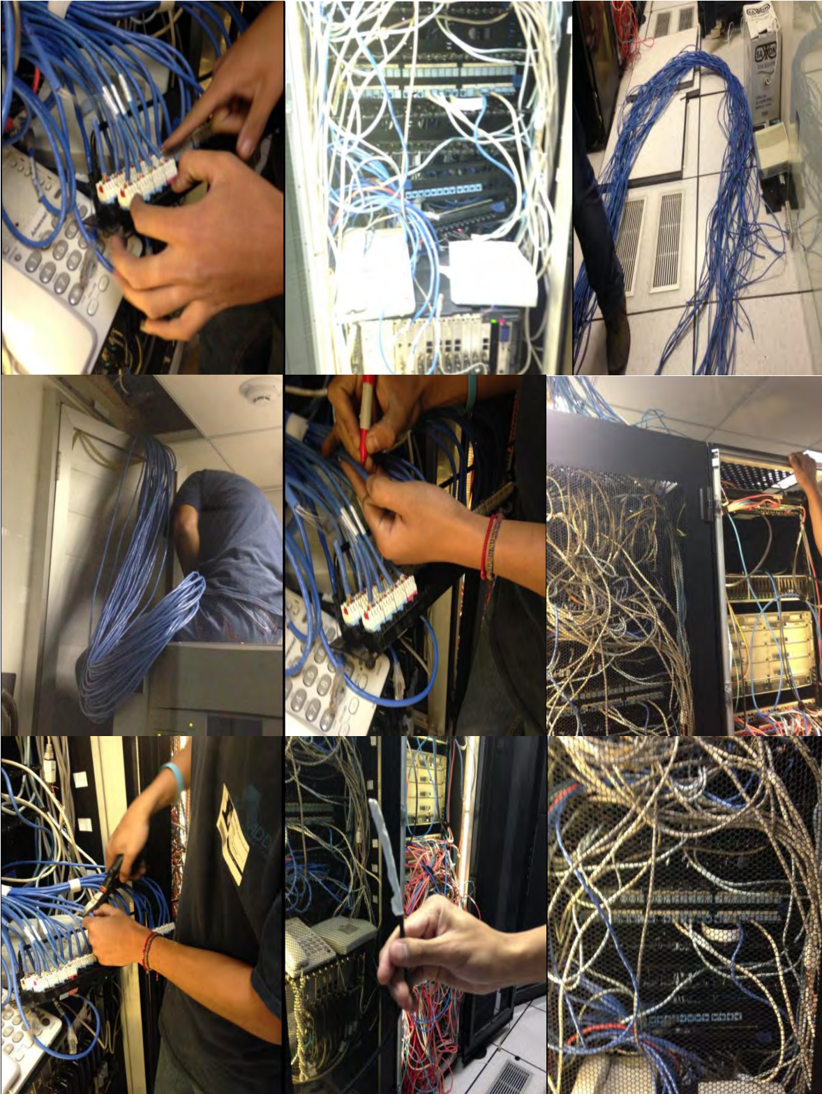
Fotografía 4.1.1. Identificación de la red y desconexiones realizadas en el site general
