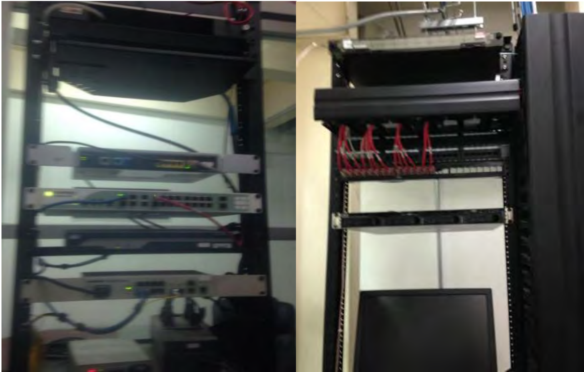
Fotografía 4.2.5g Racks con equipos de Alestra y Artco
